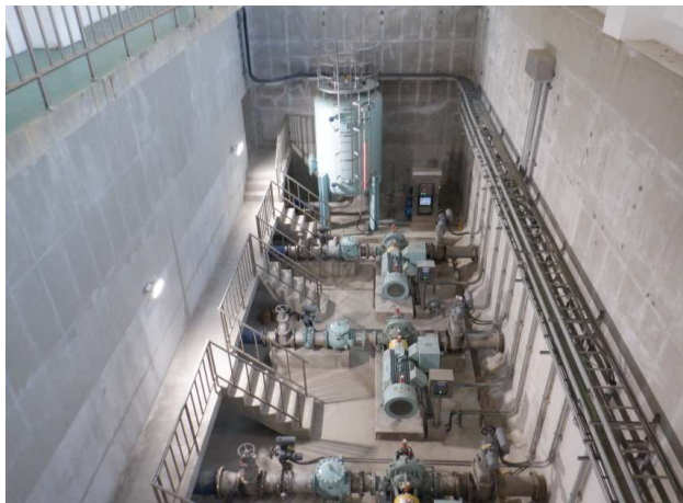
펌프 및 모터설비 전경
