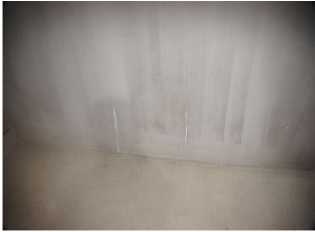
1~2호지 유입배관실 내부벽체 균열 부 백태
