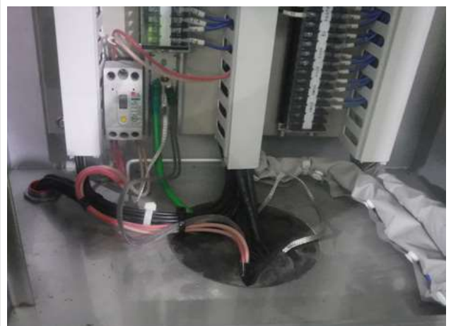
모터 현장제어반 내부 상태양호 현황
