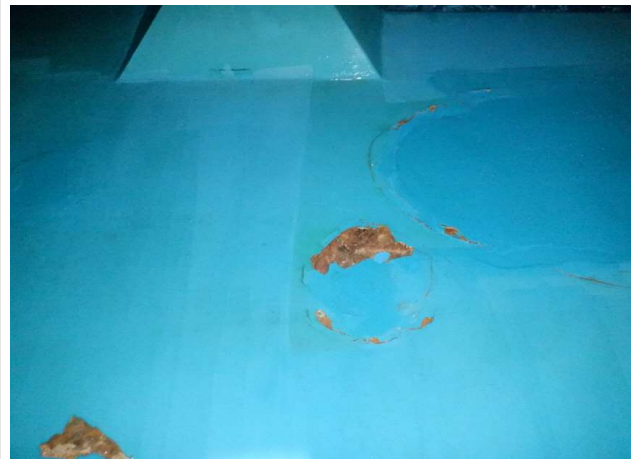
배수지4지 바닥슬래브 도장박리, 박락
