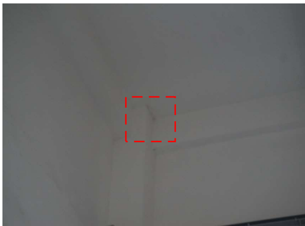
펌프실 지상1층 천장슬래브 누수흔적
