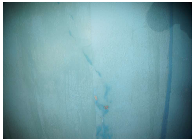
배수지2지 벽체 균열(0.3mm미만)
