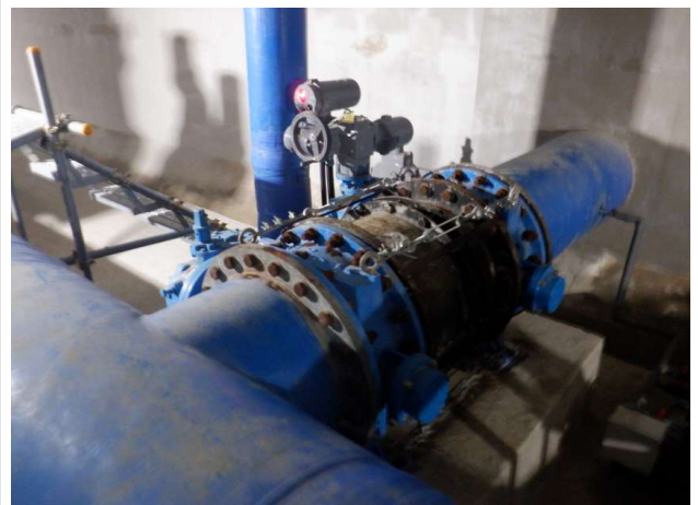
유입밸브실 밸브 상태양호
