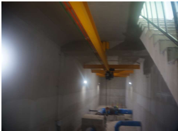
유입밸브실 호이스트 상태양호
