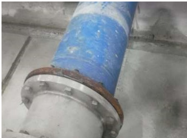
펌프실 배관 상태양호 현황
