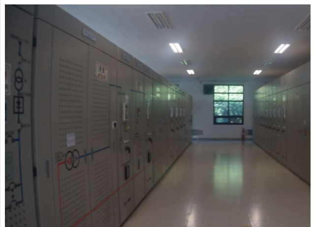
전기실 수변전설비 전경
