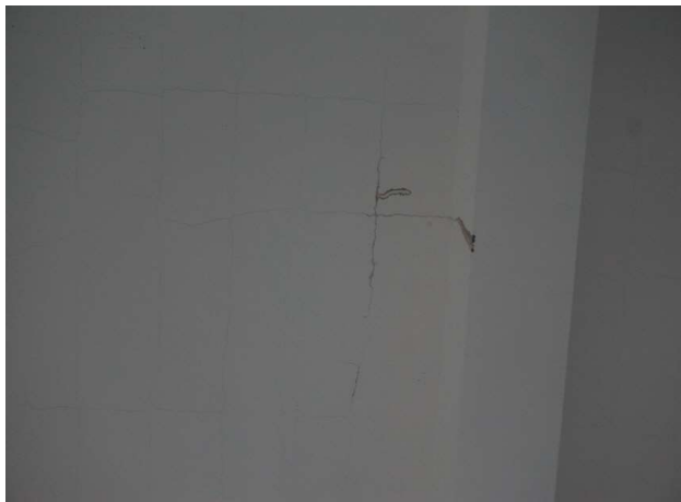
펌프실 지상1층 천장슬래브 누수흔적
