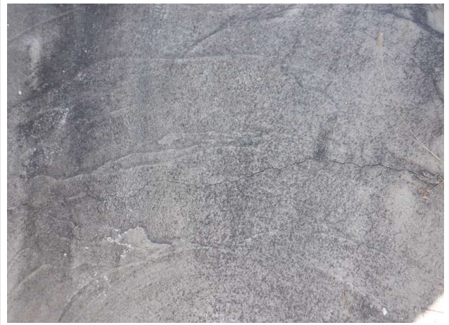
3~4호지 검수실 외부 바닥 균열
