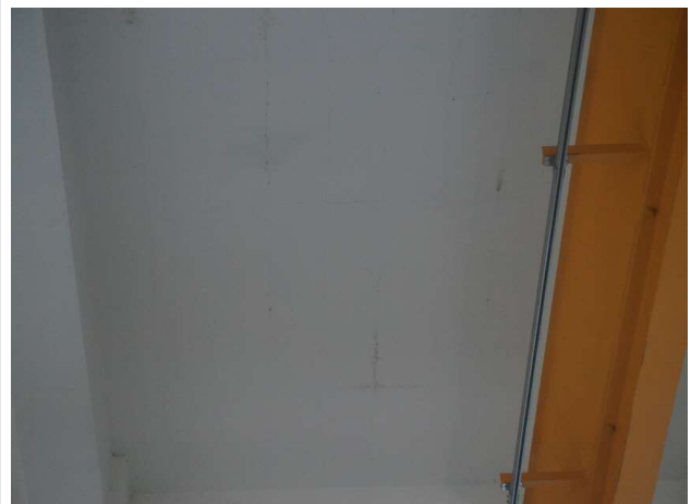
펌프실 지상1층 천장슬래브 누수흔적
