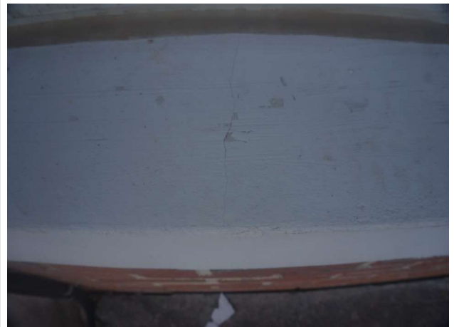
1~2호지 검수실 외부 균열(0.3mm미만)
