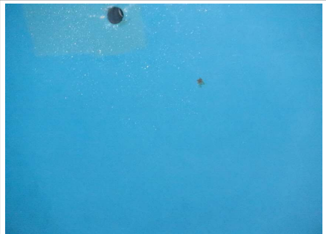
배수지4지 상부슬래브 녹물
