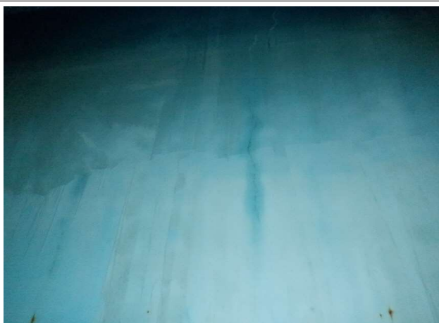
저류조 및 흡수조 1지 내부벽체 균열(0.3mm미만)
