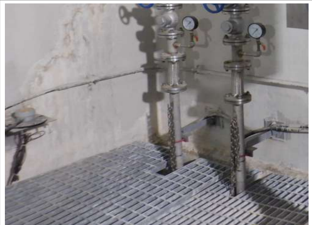
배수펌프 설치 상태양호 현황
