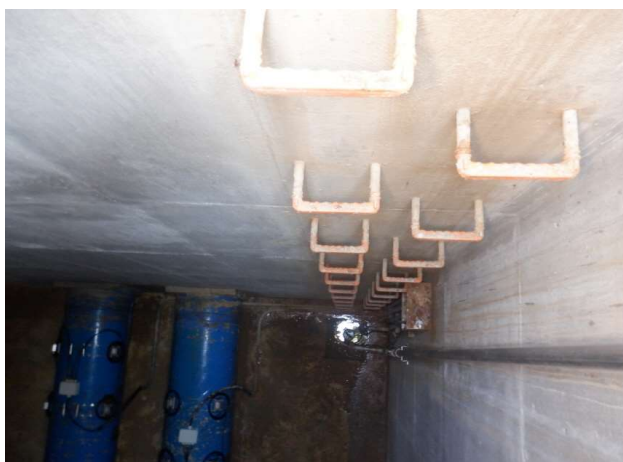
유량계실 내부 상태양호
