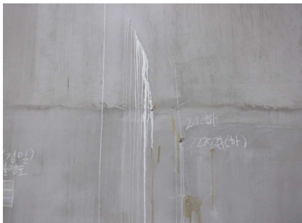
3~4호지 유입배관실 벽체 균열 부 백태
