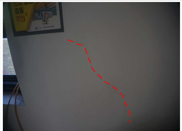
펌프실 지상1층 벽체 물탈균열(0.3mm이상)
