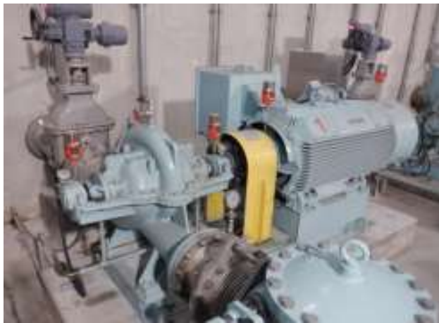
펌프 상태양호 현황
