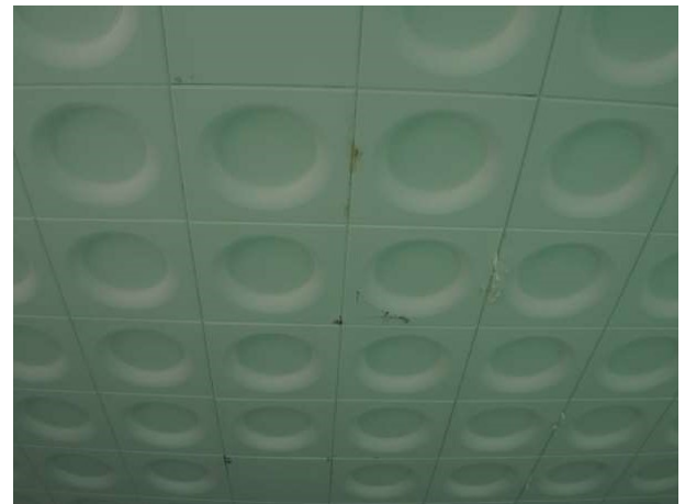
1~2호지 검수실 내부 천장 누수흔적
