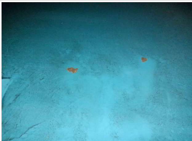
배수지3지 바닥슬래브 도장박리, 박락
