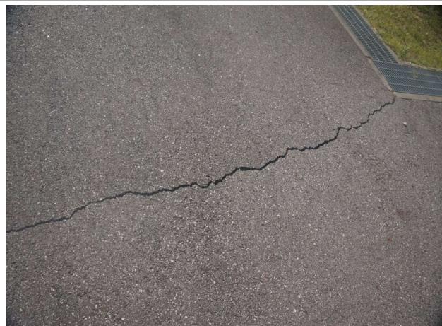
장내포장 아스팔트 균열
