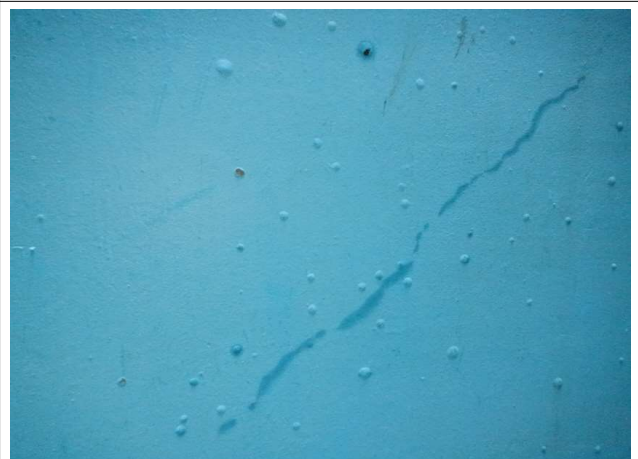
저류조 및 흡수조 1지 내부벽체 균열(0.3mm미만)
