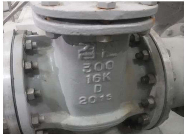
펌프실 배관 플랜지체결 상태양호 현황
