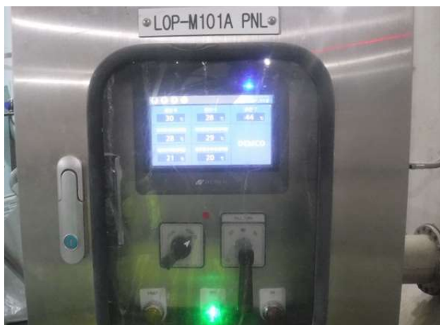
모터 현장제어반 전경
