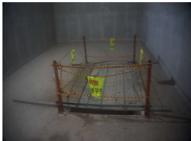
유입밸브실 안전 난간 미설치
