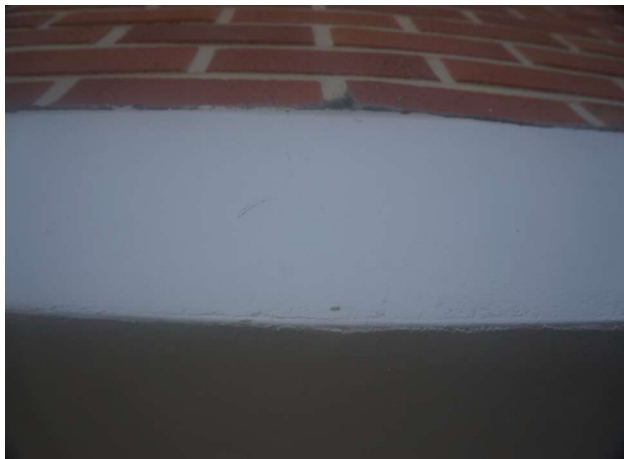
1~2호지 검수실 외부 균열(0.3mm미만)
