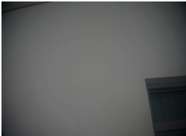
전기실 내부벽체 물탈 망상균열
