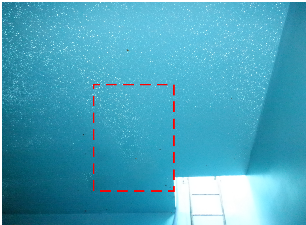
저류조 및 흡수조 1지 상부슬래브 균열/백태
