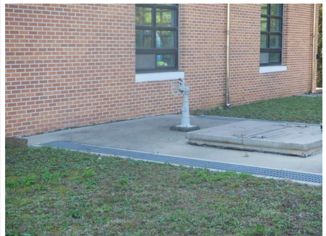
저류조 덮개 상태양호 현황
