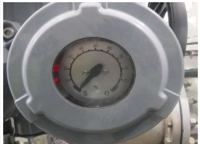
전동밸브 개도계 상태양호 현황
