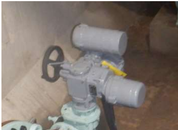
저류지 유입밸브 전경
