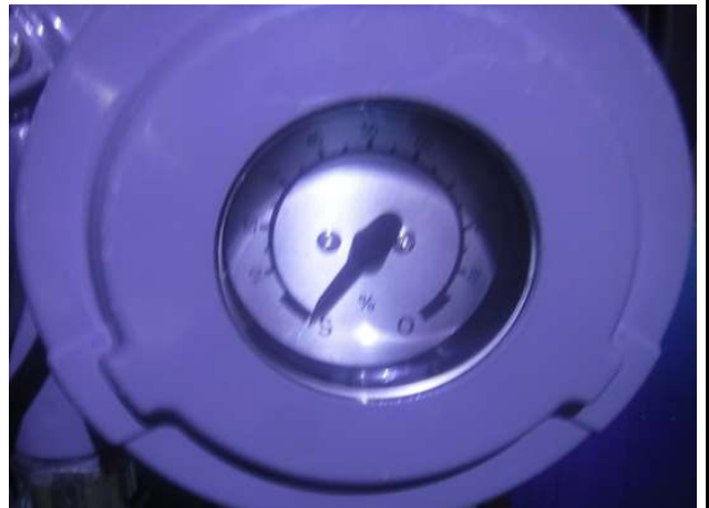
저류지 유입밸브 개도계 상태양호 현황
