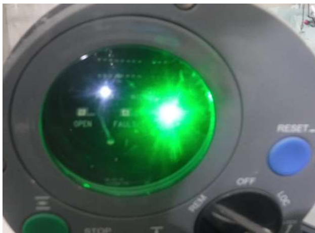
전동밸브 상태양호 현황
