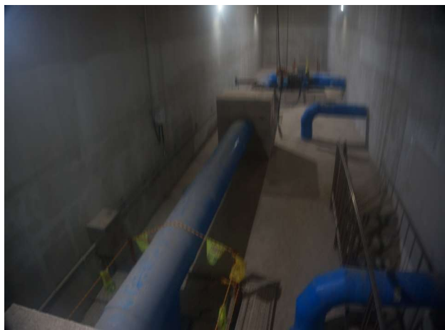
유입밸브실 배관 상태양호
