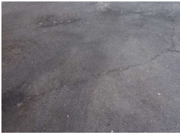
3~4호지 검수실 외부바닥 균열
