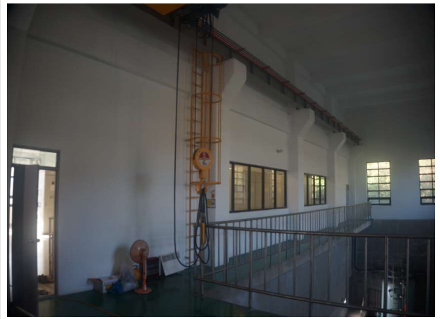
호이스트 진입사다리 상태양호 현황
