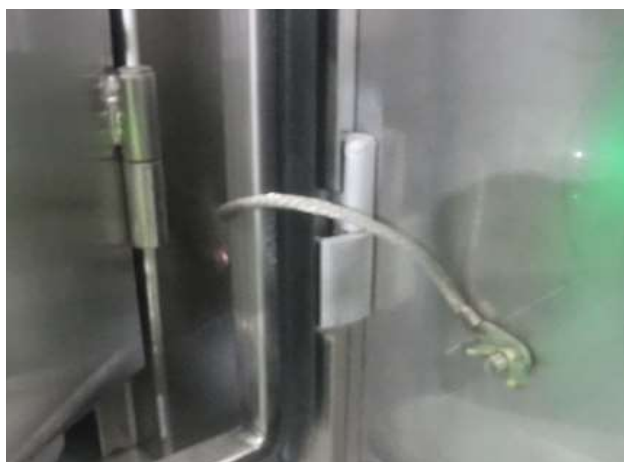
모터 현장제어반 도어본딩접지 상태양호 현황
