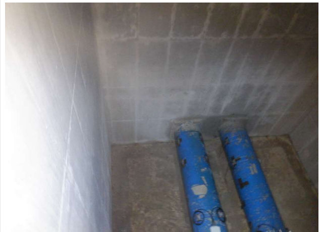
유량계실 내부 상태양호
