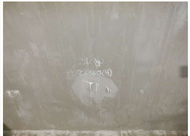
3~4호지 유입배관실 벽체 백태
