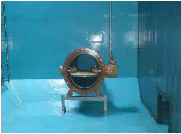
저류지 유출 수동밸브 상태양호 현황
