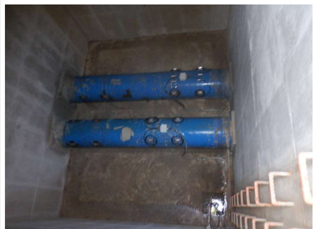
유량계실 내부 상태양호
