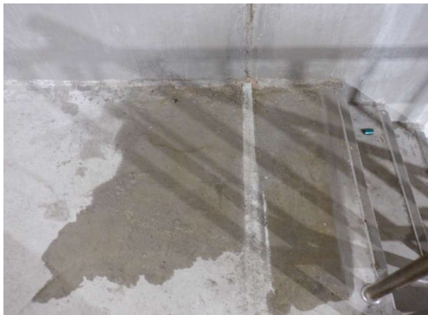
3~4호지 유입배관실 바닥 이음 열화
