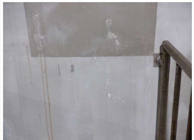
3~4호지 유입배관실 벽체 균열 부 백태
