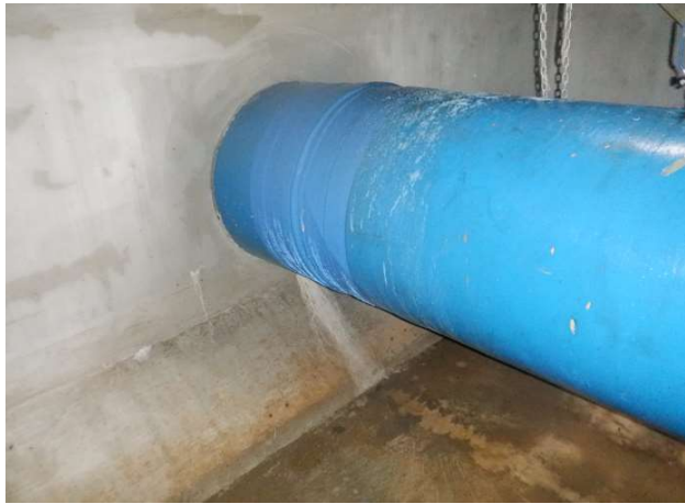
저류지 유입배관 상태양호 현황
