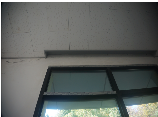
전기실 내부벽체 누수흔적
