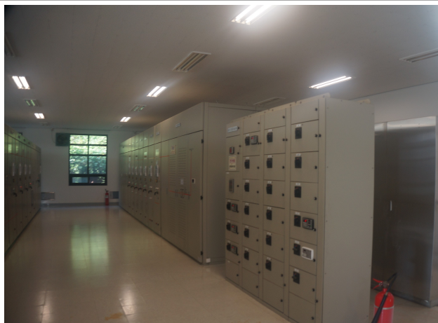
전기실 수변전설비 전경
