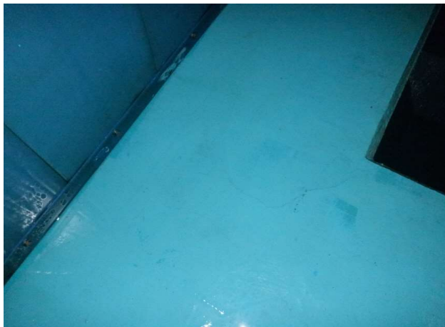
배수지4지 바닥슬래브 균열 부 백태
