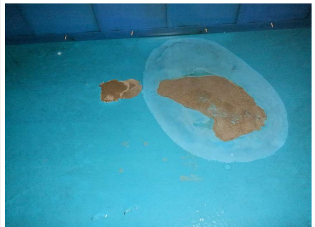
배수지3지 바닥슬래브 기포, 도장박리, 박락
